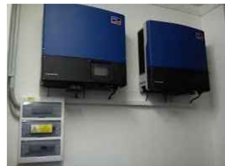
INSTALLAZIONE TIPO INVERTERS
